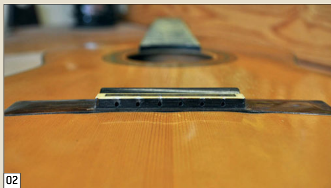
02 Le chevalet est décollé en trois endroits. Depuis plusieurs années dans cet état, la table s'est affaissée. Une remise en forme préalable de la voûte est nécessaire pour que la table puisse faire contact à nouveau avec le chevalet.
